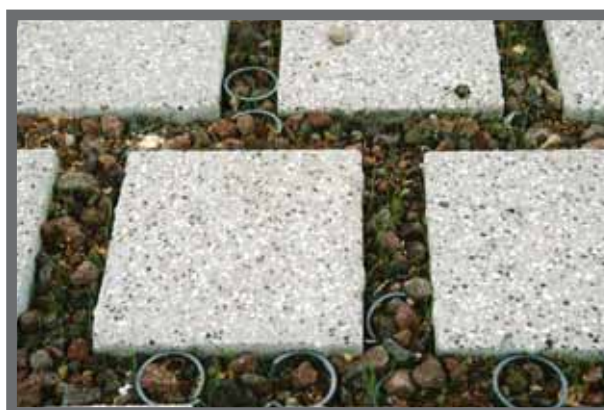
... zu hohe Fugenverfüllung...
