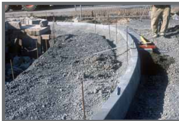
Bild 4 bis 6: Häufige Fehler bei Planung und Bau von Begrünbaren Belägen: Zu hohe Verdichtung beim Bau...
